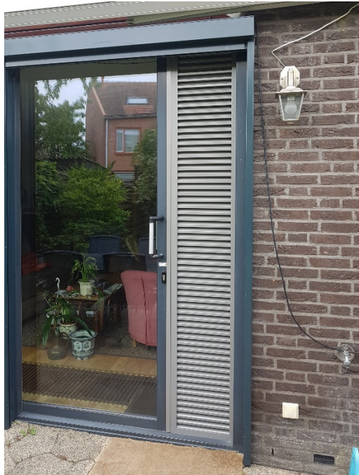
Ventilatierooster in schuifpui voor zomernacht-ventilatie. Ook is een screen aangebracht om direct zonlicht overdag van de ramen te houden.
